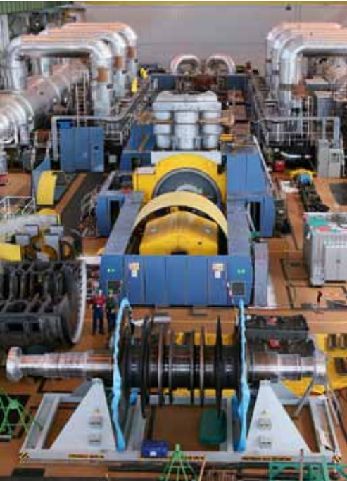
Pohled do strojovny 1. bloku JE Temelín při odstávce, během které došlo i k výměně nízkotlakých rotorů turbíny
