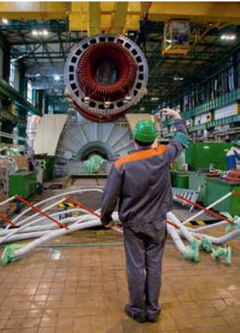
Výměna statoru generátoru na 3. bloku EDU – součást modernizačního programu a zajištění dlouhodobého provozu Pohled do strojovny 3. bloku EDU při odstávce
