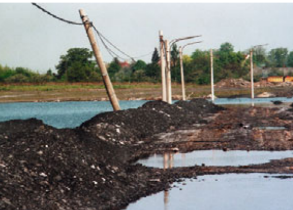
Kabel vedení nízkého napětí
