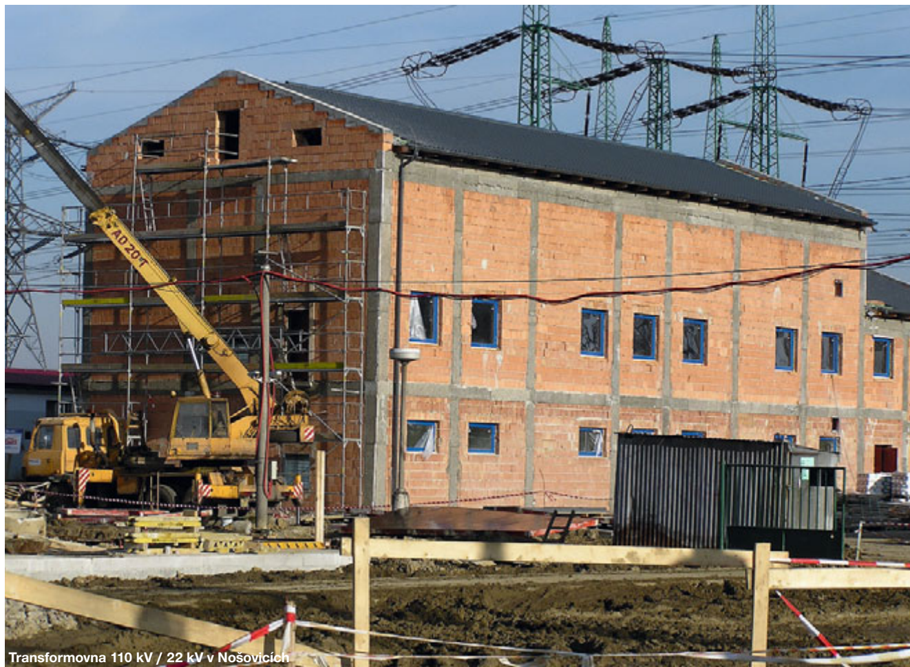
Transformovna 110 kV / 22 kV v Nosovících
