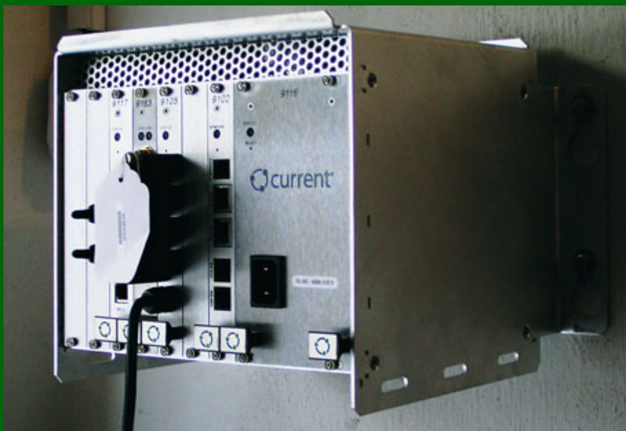
Multifunkční zařízení pro komunikaci a konektivitu instalované v trafostanici
