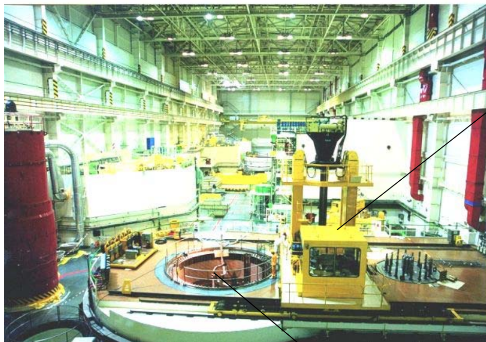
Pohled do reaktorového sálu (na některá zařízení primárního okruhu)EDU
