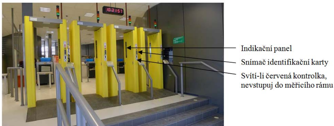
Obrázek 8 Monitory kontaminace osob (PM-7) na vstupu a výstupu ze střeženého prostoru EDU
