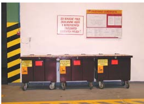
Kontejnery na zaolejované hadry ve strojovně
