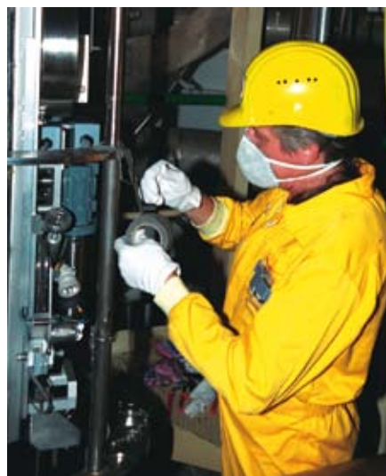
Veškeré zařízení elektrárny splňuje nejvyšší technické požadavky a je trvale udržováno v perfektním stavu.
