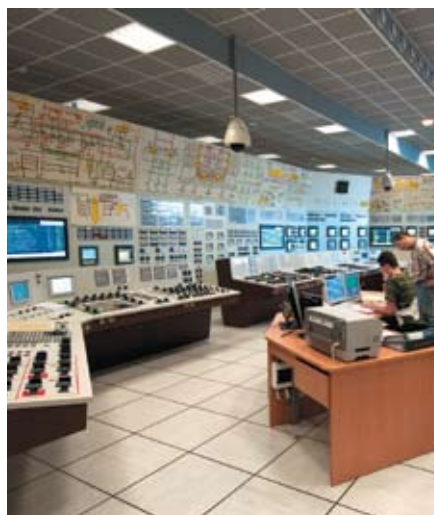
Bloková dozorna na trénažeru je přesnou kopií skutečné blokové dozorny a slouží k pravidelnému školení osádek blokových dozoren. Přispívá tak ke zvýšení kvality personálu a tím i bezpečnosti a spolehlivosti provozu jaderné elektrárny.
