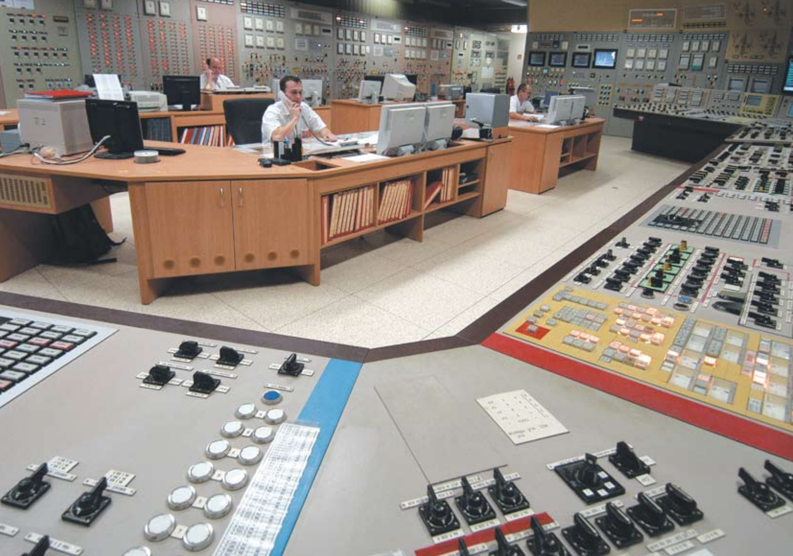
Bloková dozorna Jaderné elektrárny Dukovany
