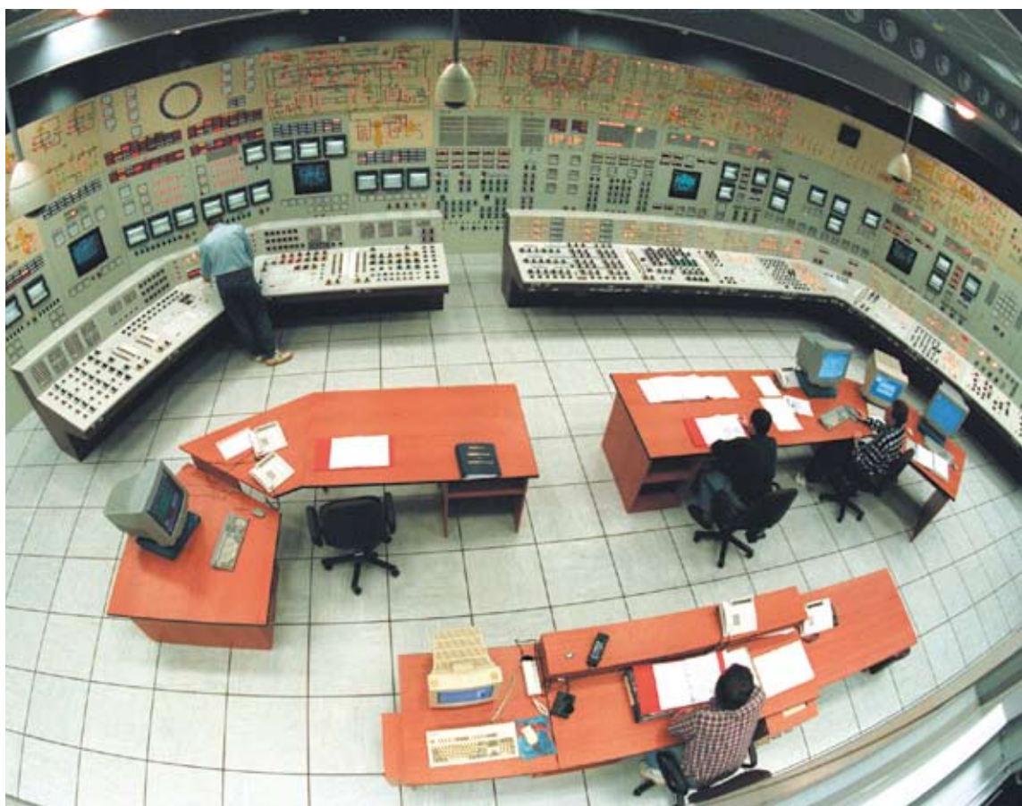
Bloková dozorna na trenažéru Jaderné elektrárny Dukovany
