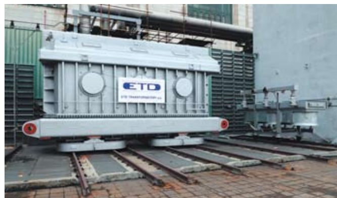
Nový transformátor je na místě, kde bude „sloužit“ téměř čtyřicet následujících let.
