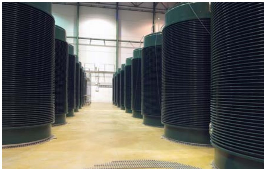
V roce 2014 bude v Temelíně v provozu podobný sklad, který vidíme na fotografii z elektrárny Dukovany.
