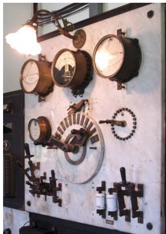
Křemežský mlýn si dochoval mnoho původních technických zařízení. Mezi ně patří i rozvodná mramorová deska dodaná ing. Františkem Křižíkem v roce 1906.
