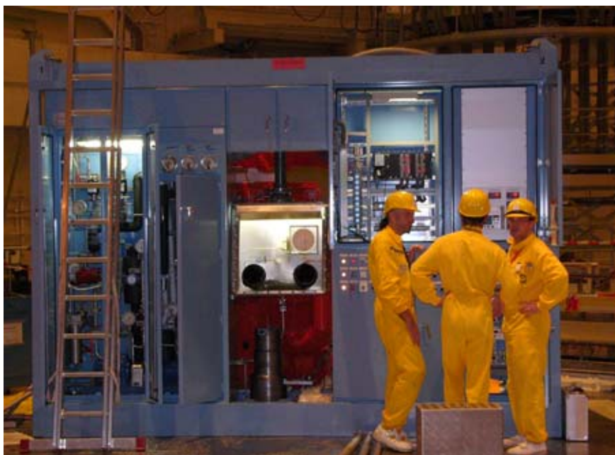
Kontrolní pracoviště „Shipping of line“ dodali na Temelín Francouzi a je na něm prováděna kontrola palivových souborů přímo na reaktorovém sále.
