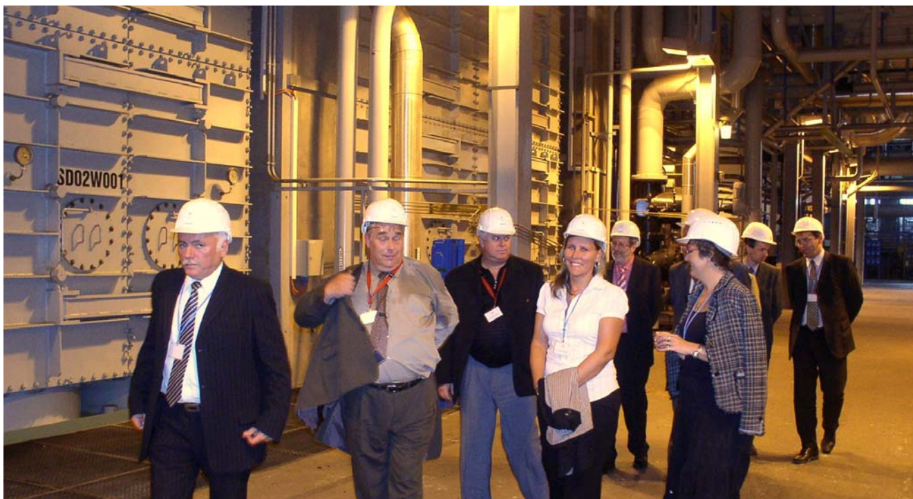
Při prohlídce elektrárny Temelín si poslanci hospodářského výboru Parlamentu České republiky prohlédli i kondenzátory pod turbinou prvního bloku.
