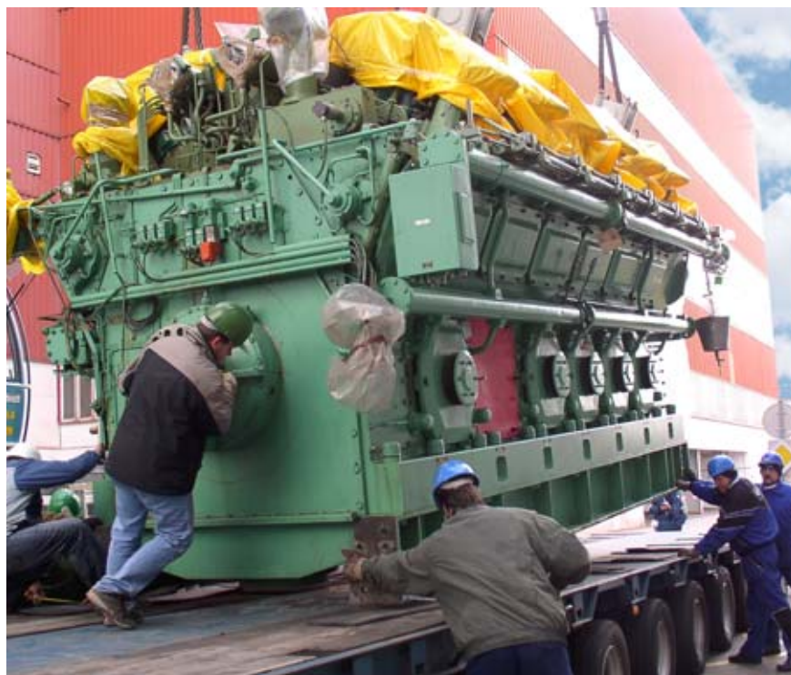
Unikátní pohled na jeden z osmi dieselgenerátorů JE Temelín. Každý má výkon 6,3 MW. Tyto agregáty slouží jako rezervní zajištění vlastní spotřeby bloků a napájejí systémy důležité z pohledu jaderné bezpečnosti.
