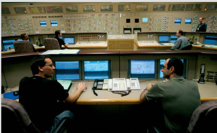
Plnorozsahový simulátor JE Temelín je matematický model elektrárny naprogramovaný na počítačích, který je nainstalován na přesné kopii blokové dozorny. Operátoři se na něm učí řídit běžný provoz reaktorového bloku, najíždění, provoz na výkonu, změny výkonových hladin a odstavování bloku. Pouze zde si mohou procvičit i málo pravděpodobné abnormální stavy bloku.
