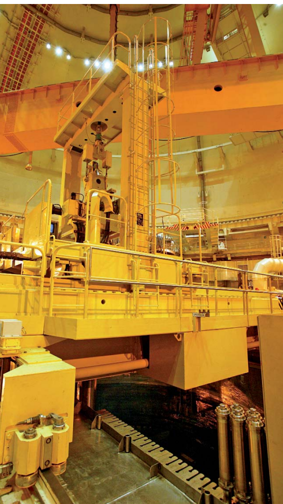
Pohled do reaktorového sálu bloků JE Temelín. V popředí je zavážecí stroj na výměnu paliva.
