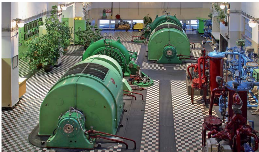
Pohled do strojovny MVE Vydra
