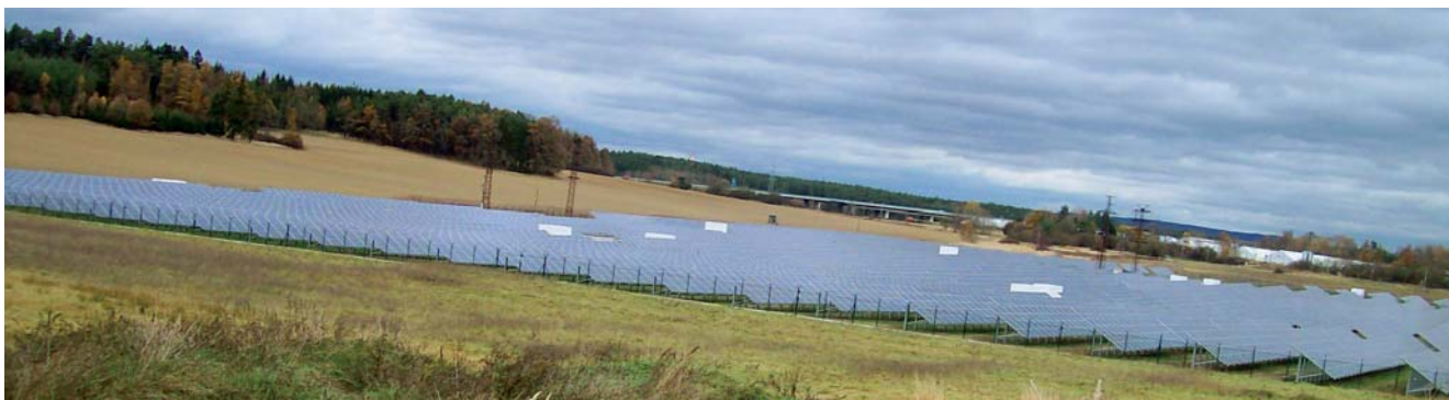
Solární elektrárna v Čekanicích u Tábora
