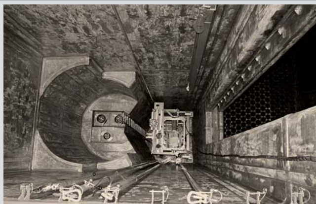
Bázen výměny paliva je umístěn vedle bazénu použitého paliva a je do něho zavážen zásobník s čerstvým palivem i kontejner CASTOR v době jeho plnění.
