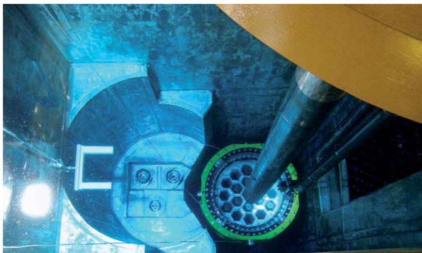
Unikátní pohled do bazénu, ve kterém se pomocí zavazecího stroje plní kontejnery CASTOR použitým palivem z bazénu skladování.
