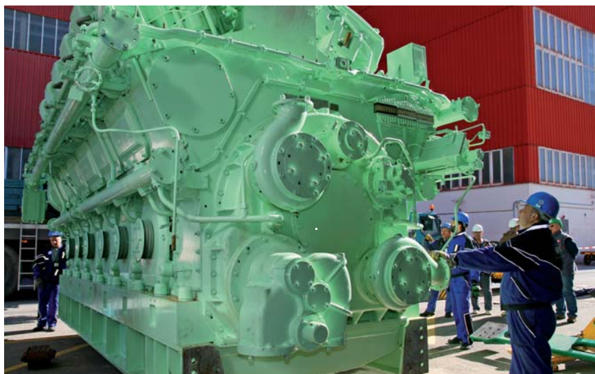
Diesलगenerátor je jedním z důležitých bezpečnostních zařízení z pohledu zajištění elektriny při výpadku napájení bloků. Na Temelíně je takových lodních motorů osm.
