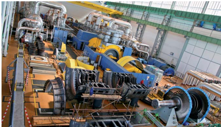
Letos čeká elektrárnu při odstávkách hodně práce na strojovnách. Na snímku vidíte pohled na strojovnu v době, kdy vrcholí kontroly turbogenerátoru.
