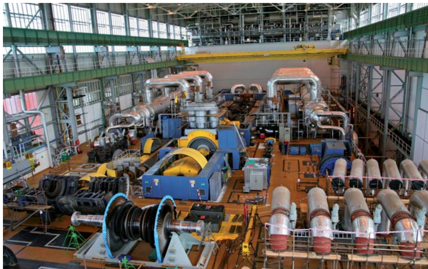
Pohled do strojovny při odstávce, během které je každoročně kontrolováno turbosoustrojí.
