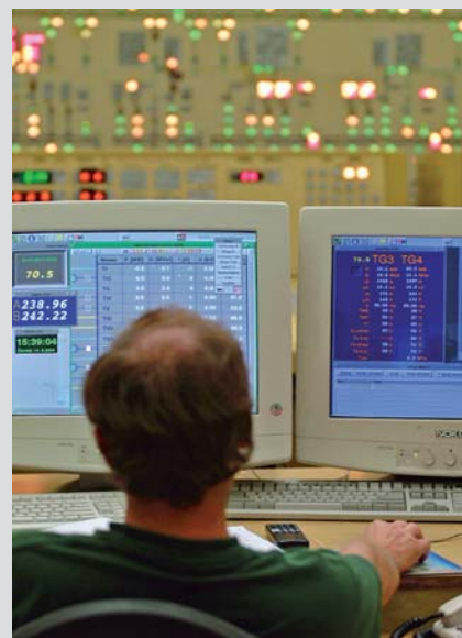
Provoz elektrárny Hodonín je řízen z tohoto velína.
