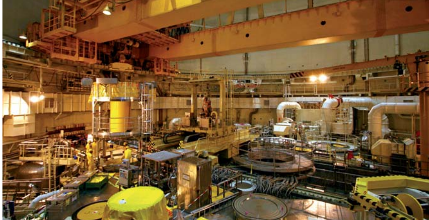
Pohled na reaktorový sál prvního bloku při odstávce. Na dolní fotografii vlevo vidíme usazování naplněného kontejneru CASTOR na servisní místo, kde bude provedeno jeho vysušení a uzavření druhým horním víkem. Na fotografii vpravo kontrolují pracovníci ČEZ Jan Žižka a Antonín Hudeček právě druhé (sekundární) víko kontejneru.
