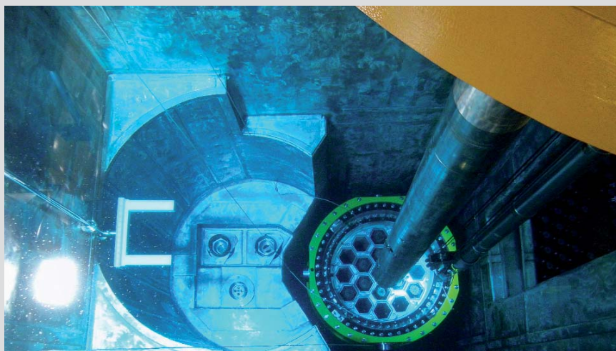
Pohled do bazény výměny při ukládání použitého paliva do kontejneru CASTOR. Tato manipulace probíhá za odstávky a pod vodou. Do jednoho kontejneru se vejde 19 palivových souborů.
