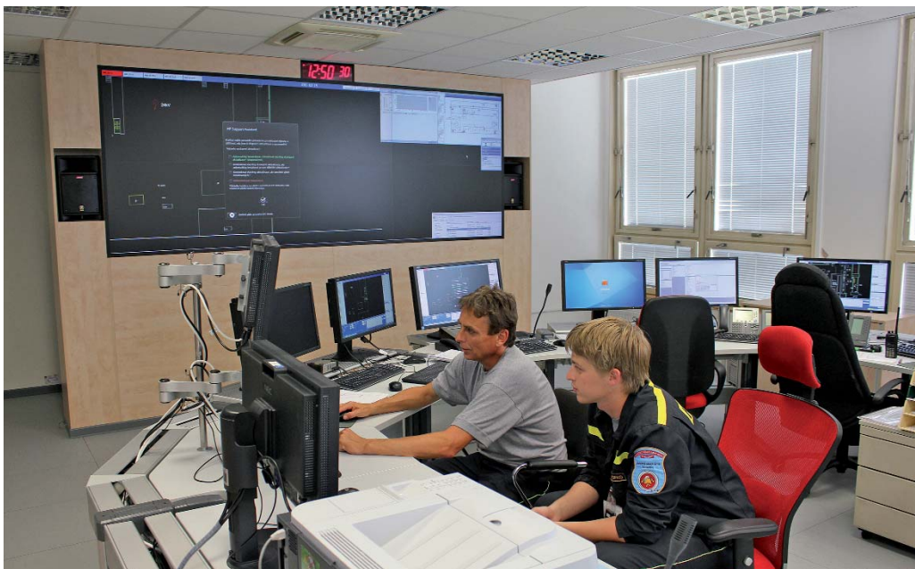
Moderní řídicí pracoviště hasičů, do kterého se schází tisíce signálů požární signalizace z bloků Jaderné elektrárny Temelín.
