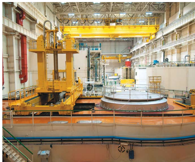
Pohled do reaktorového sálu - vlevo závazcí stroj, vpravo víko reaktoru
