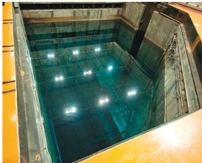
Pohled do bazénu skladování, v němž jsou umístěné kazety s použitým palivem před transportem do meziskladu použitého paliva
