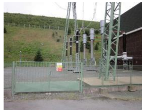
Vývodové pole 400kV
