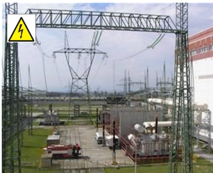
Rozvodny, transformovny (vn)
