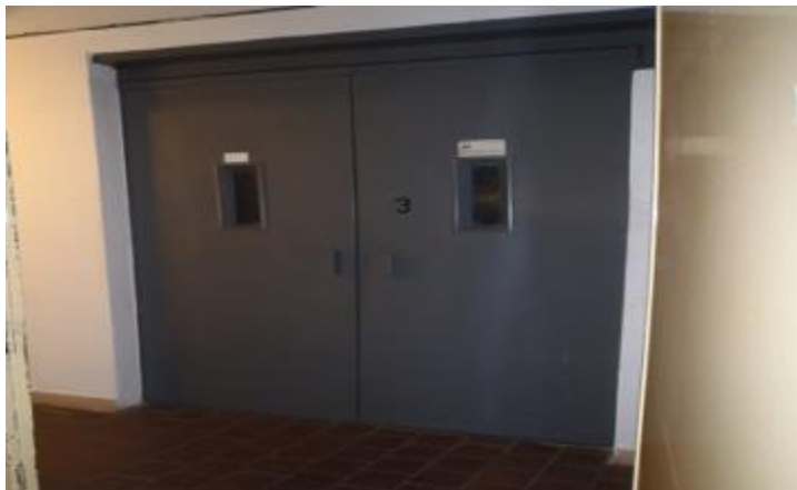
Nákladní výtah ve strojovně
