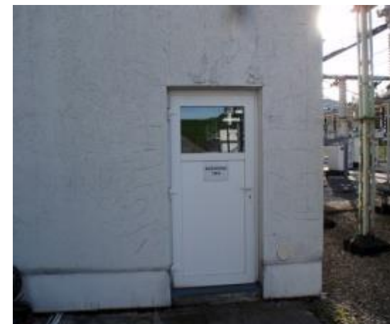
Vstup do rozvodny 15kV
