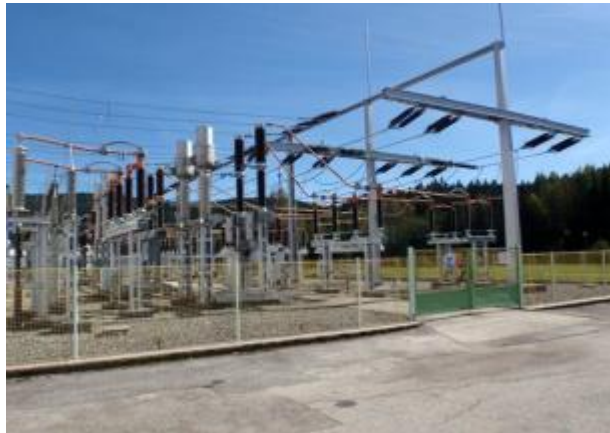
Vstup do vývodového pole
