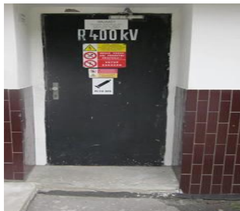
Vstup do rozvodny 400kV
