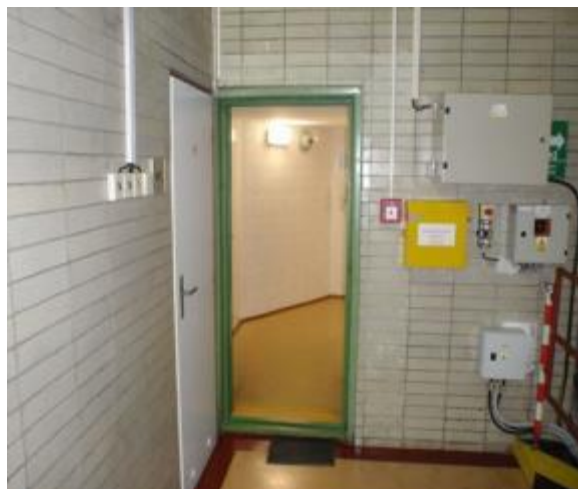
Vstup k osobnímu výtahu ze strojovny ELI I
