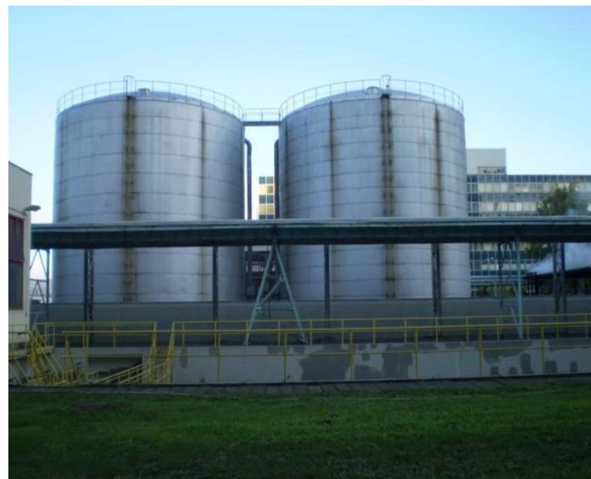
Zásobníky mazutu pro pomocnou kotelnu, která slouží při odstávkách k ohřevu vody a zajištění tepla
