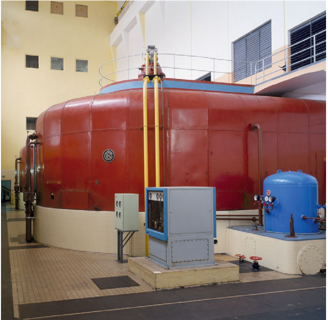
Strojovna vodní elektrárny Štěchovice
