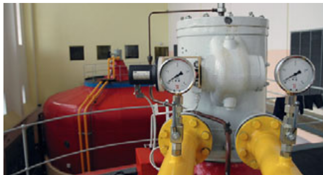
Strojovna vodní elektrárny Štěchovice
