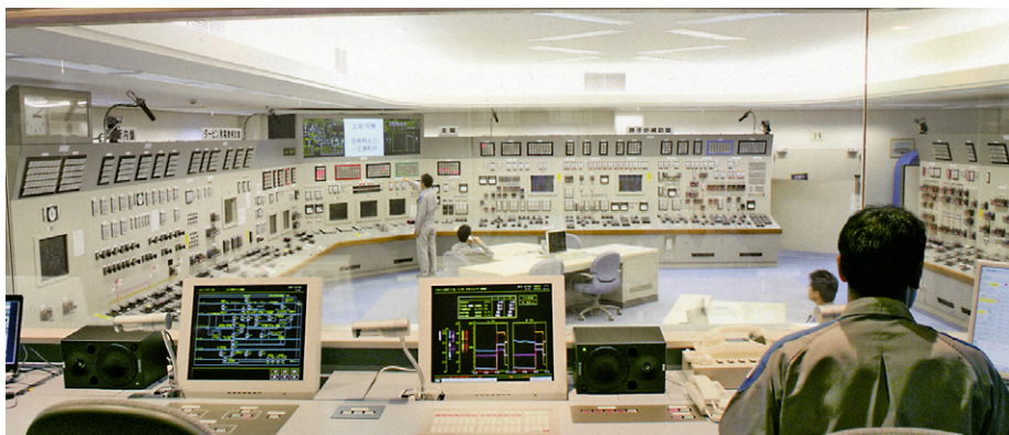
Pohled do „blokové dozorny“ ve školicím a výcvikovém centru
