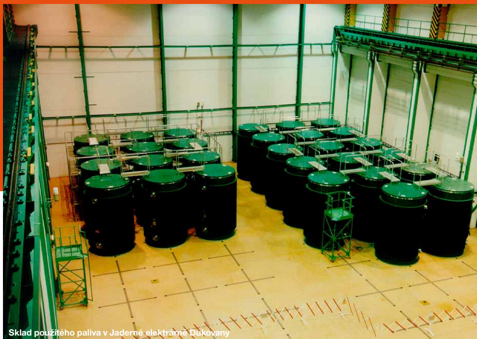
Sklad použitého paliva v Jaderné elektrárně Dukovany
