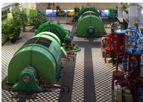
Interiér vodní elektrárny Vydra
