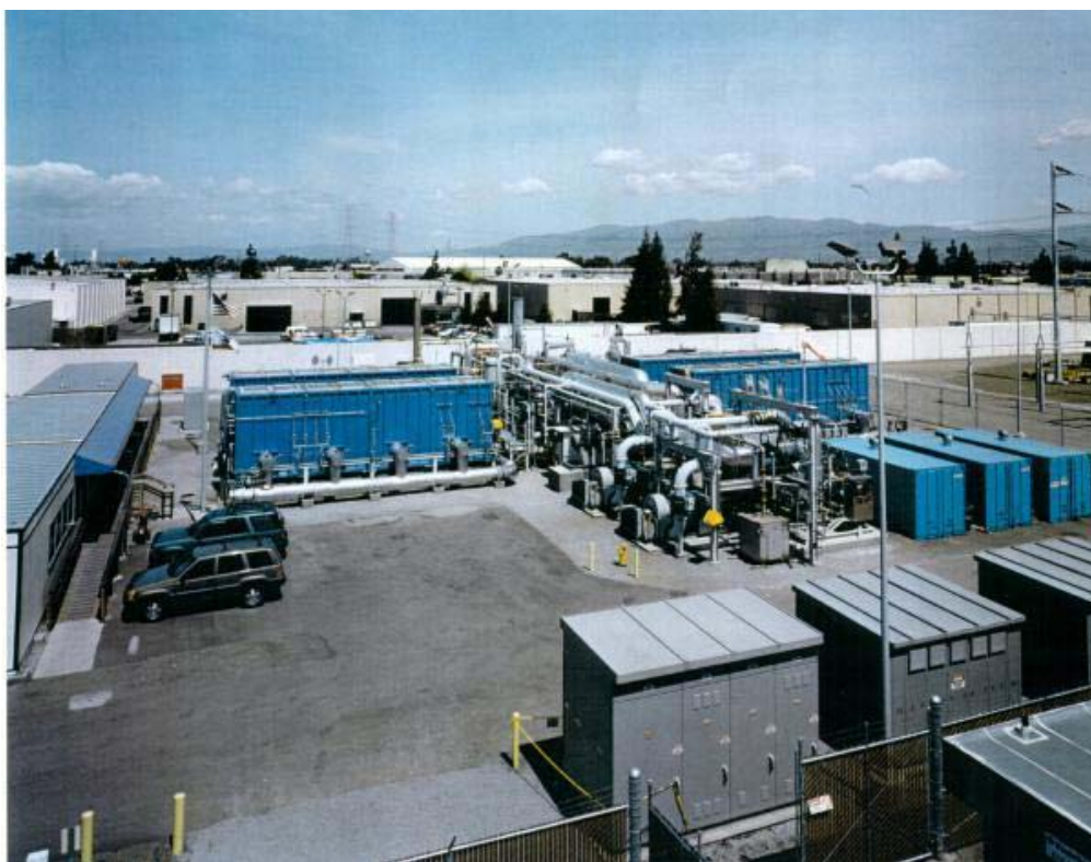
Obr. 6-25 2MW elektrárna s palivovými články FuelCell Energy, Santa Clara, Kalifornie, USA [37]
