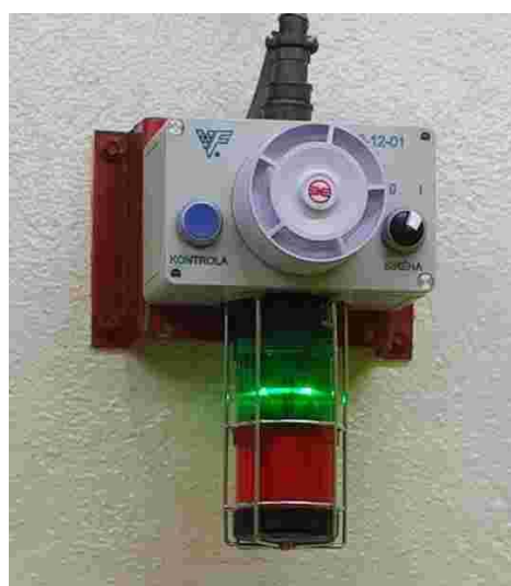
Signalizační jednotky stabilního dozimetrického systému
