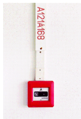
Vnitřní tlačítkový hlásič požáru
