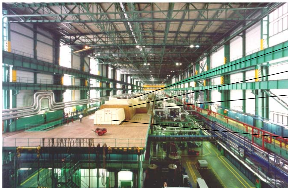
Pohled do strojovny (na některá zařízení sekundárního okruhu)EDU
