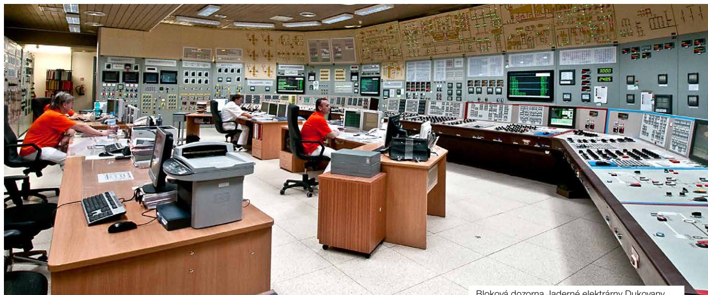
Bloková dozorna Jaderné elektrárny Dukovany
