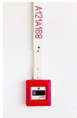
Vnitřní tlačítkový hlásič požáru
