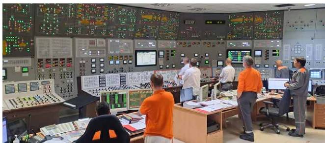
Bloková dozorna 1. RB při spuštění bloku po odstávce
