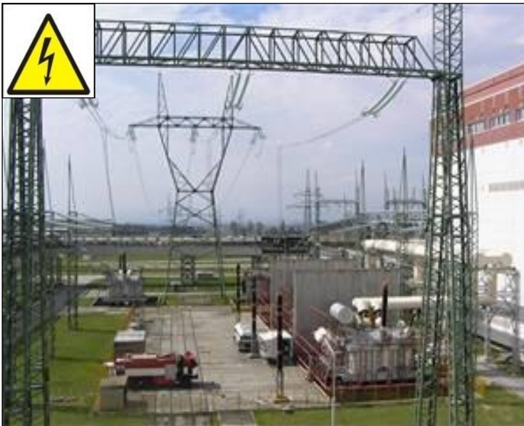
Rozvodny, transformovny (vn)
