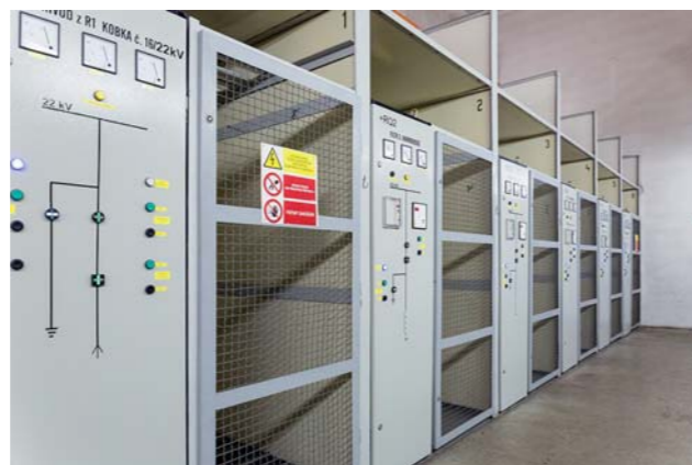
Rozvodna R22 – Darkov
