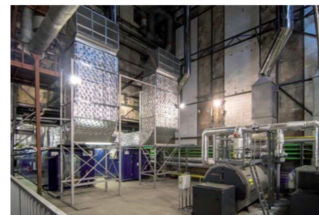
Instalace KGJ v Teplárně Vítkovice
