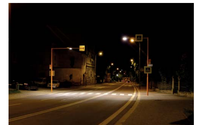
Osvětlení přechodu – Trutnov
