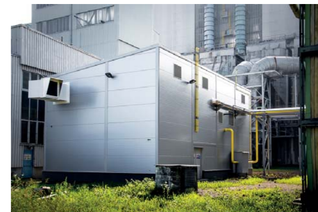
Elektrárna Dětmárovice – plynová kotelna
