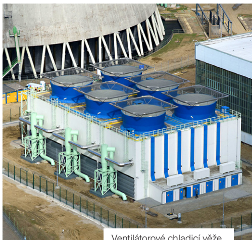
Ventilátorové chladicí věže
