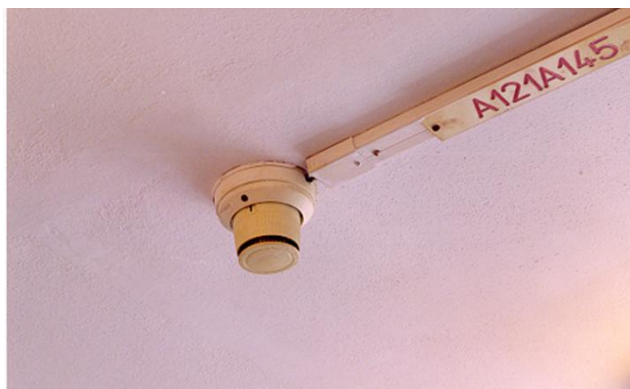
Obrázek 7.5: Elektrická požární signalizace (EPS)
