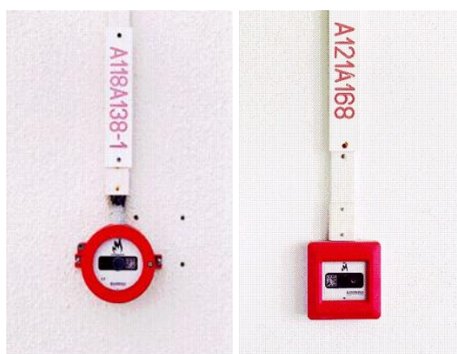
Obrázek 7.6: Venkovní a vnitřní tlačítkový hlásič požáru
